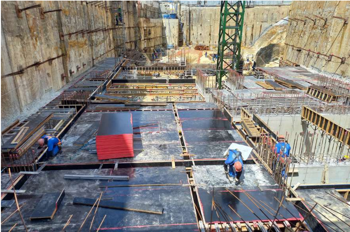
Imagem 126: Obra Edifício Birmann - São Paulo - fôrma de madeira para lajes e vigas
