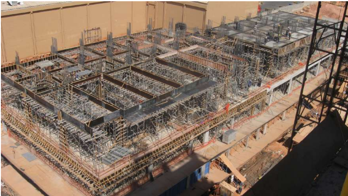
Imagem 125: Obra Century Plaza - Distrito Federal - fôrma de madeira para vigas e pilares
